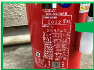
消火器にラベルが貼付 されております。
